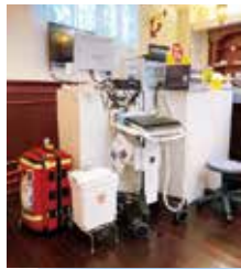
医務室の一部。すぐに対応できるように準備しています。
